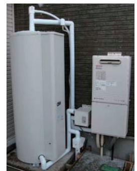
DC貯湯槽（左）から ボイラ（右）を経由して 屋内に給水
