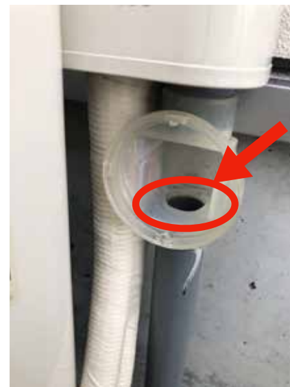
⑦排水トラップの内部にも不純物 が詰まっていないか確認する
